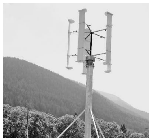
Geringer Platzbedarf. Vertikale Windgeneratoren, Oelmühle Möriken GmbH, Möriken (Aargau).
