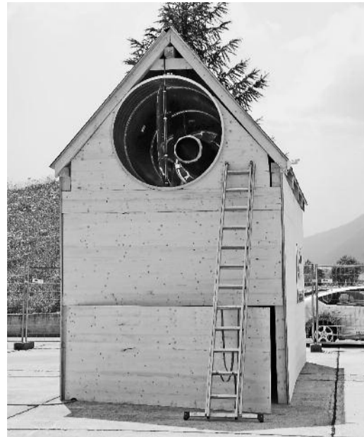
Ohne Lärm. Axiale Windturbine im Dachgeschoss, Lauber IWISA AG.
